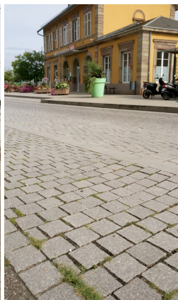
Devant la gare avec les joints ouverts
