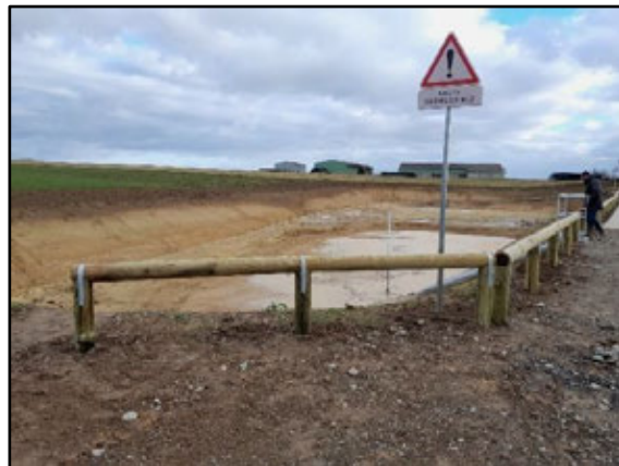
Figure 16 : Bassin de rétention sur la commune de Schwindratzheim (SDEA)
