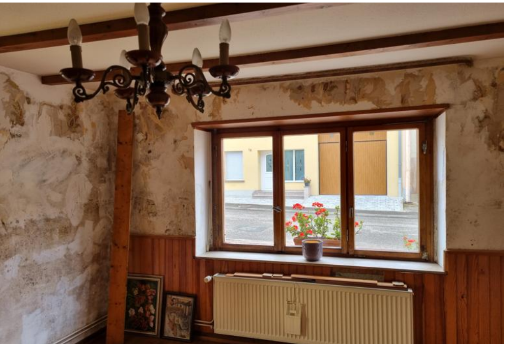
Les murs intérieurs ont besoin d'être retapisés et les sols changés. Photo Simone Giedinger
